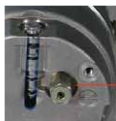
Valvola di scarico
